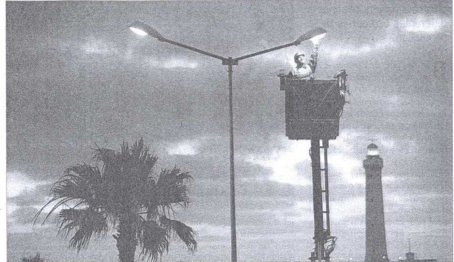
Le volet éclairage public du PAP de proximité, qui a bénéficié d'une enveloppe de 138 MDH, a comme priorité la mise à niveau du réseau dans les zones périphériques récupérées en gestion déléguée depuis avril 2013.
