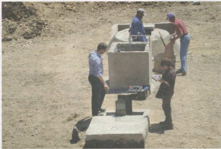
La méthanisation des déchets organiques pour la production de biogaz est la solution idoine pour les agriculteurs marocains obligés de supporter les coûts élevés de l'électricité et du gasoil, énergie nécessaire à l'irrigation de leurs terres (Ph. BM)
