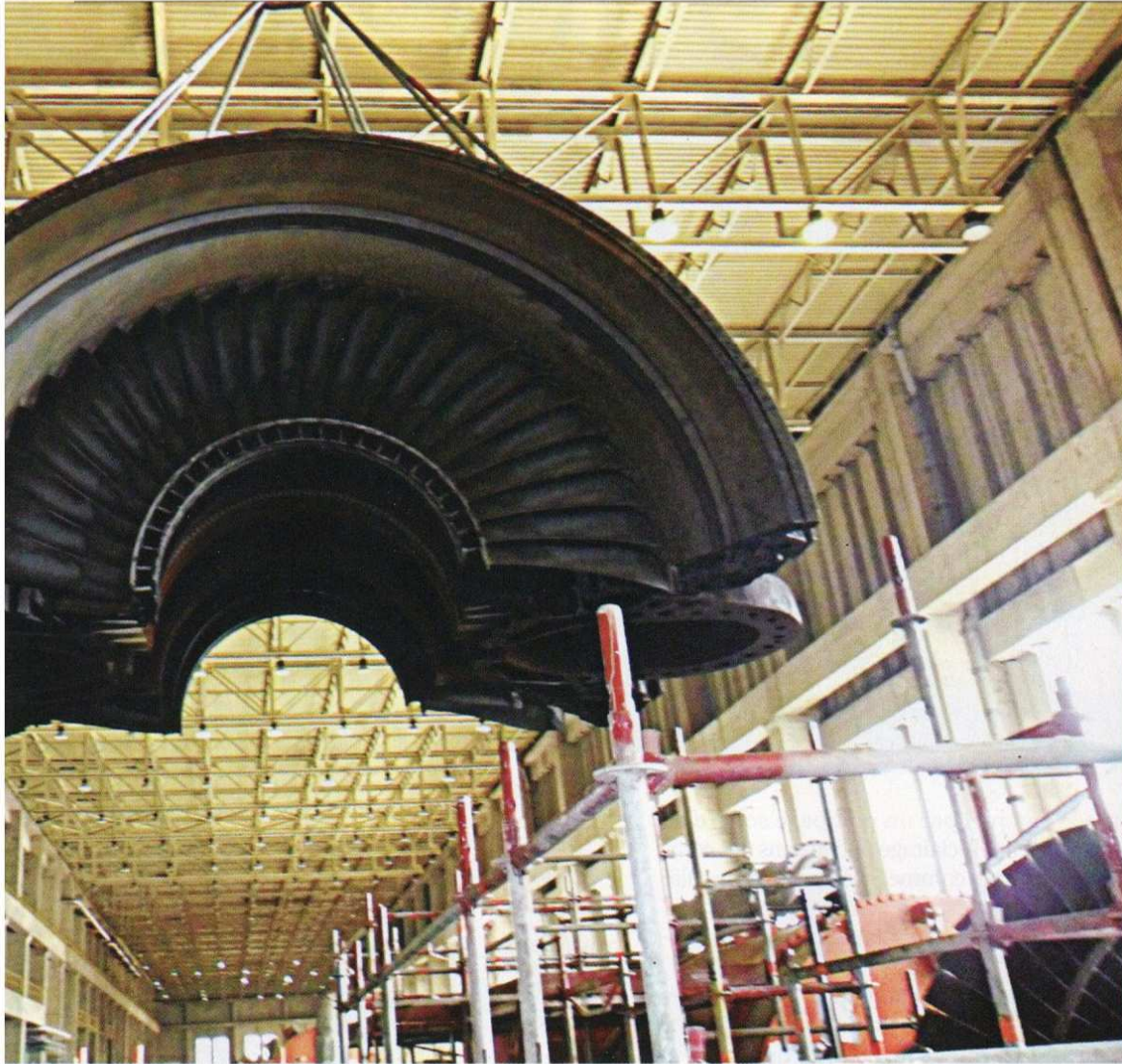
Révision de la turbine dans le cadre du plan de maintenance à Jorf Lasfar.
