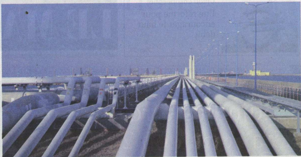
«Gas to Power» porte sur le développement des terminaux de regazéification et de stockage du GNL, des gazoducs de transport du gaz naturel et des CCGT pour la production de l'électricité.
