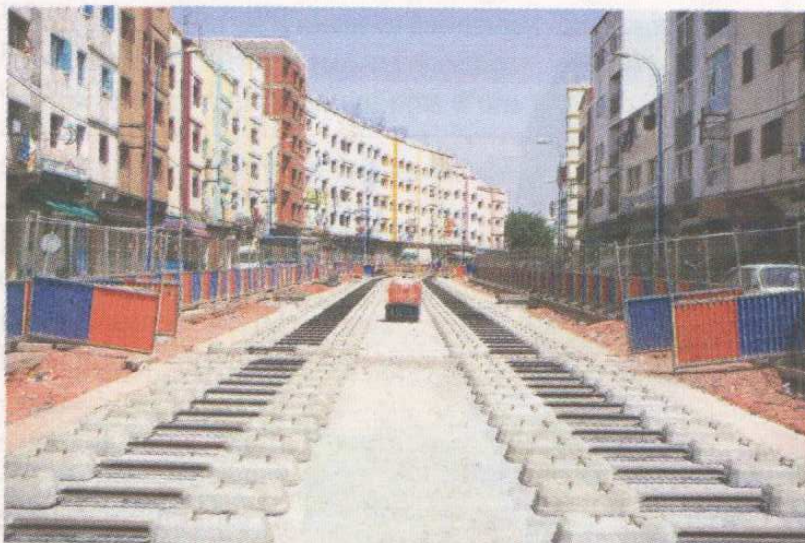
Les travaux sur la plateforme de voie ferrée pour la 2e ligne de tramway sont assez avancés sur le tronçon El Fida (Ph. Casa Transports°)
