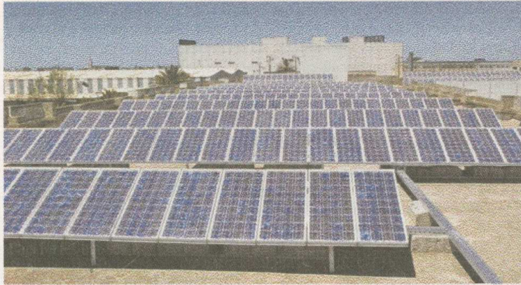
140.000 m 2 de panneaux photovoltaïques seront installés sur le projet Logintek Settat. Ils permettront de générer pas moins de 13 mégawatts (Ph. L'Economiste)
