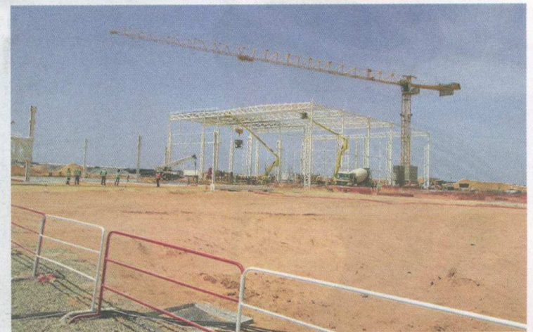
Après l'achèvement des travaux de terrassement, il sera procédé à la construction des différents ateliers du complexe industriel (Ph. NEA)
