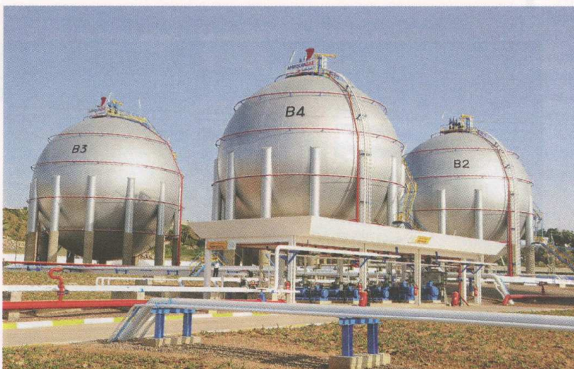
Le projet «Gas To Power» comprend un terminal à Jorf Lasfar pour l'importation du GNL à partir de 2021. Les besoins annuels sont estimés à 5 milliards de mètres cubes dont 3,5 milliards alimenteront les centrales électriques (Ph. L'Economiste)
