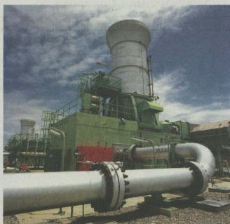
Le Maroc récupérera les infrastructures (gazoduc) existant sur le territoire, dès l'expiration de l'accord avec l'Algérie en 2021. Transporter le gaz, produit localement sera une nouvelle vocation pour le GME (Ph. L'Économiste)
