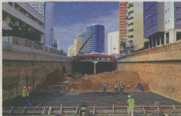
Longue de 2,2 km, la trémie des Almohades (du nom du boulevard éponyme), reliera la mosquée Hassan II, la Marina et la gare Casa-Port au Bd des FAR. Elle doit être livrée fin 2019 (Ph. Casa-Aménagements)
