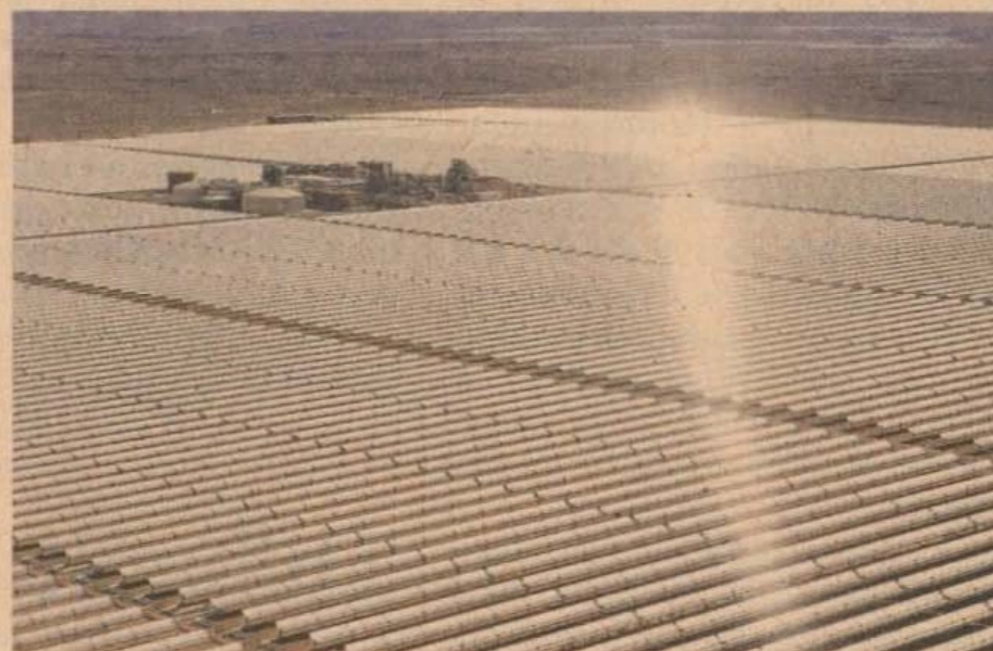
Panneaux solaires du site Noor I à Ouarzazate.
