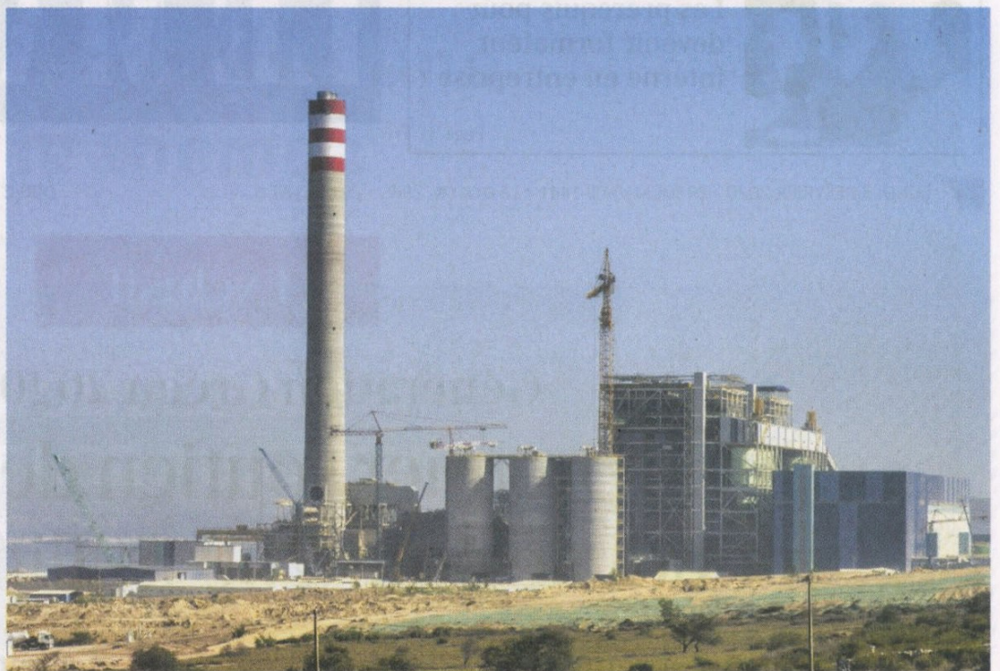
Dotée de deux unités totalisant une puissance installée de 1.386 MW, la centrale thermique de Safi a nécessité plus de 23 milliards de dirhams d'investissement.
